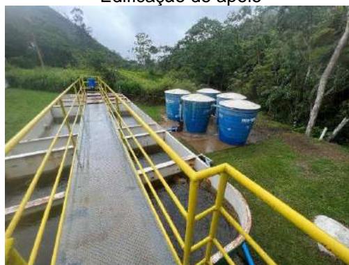
Floculação e decantação
