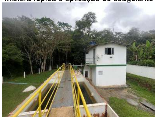
Floculação e decantação
