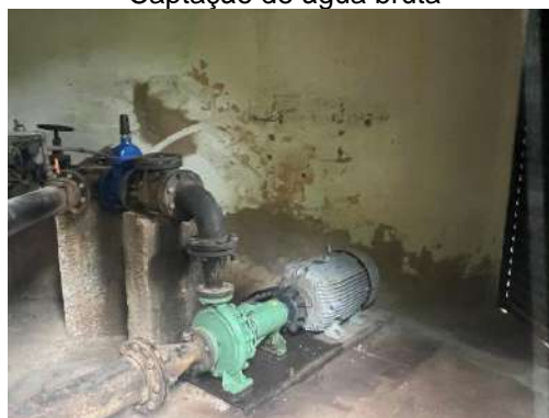
Captação de água bruta
