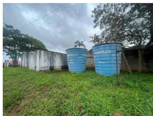
RAP Centro (fibra - 2x20 m 3 )
