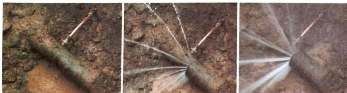
Figura 116 - Influência da pressão em um vazamento.
