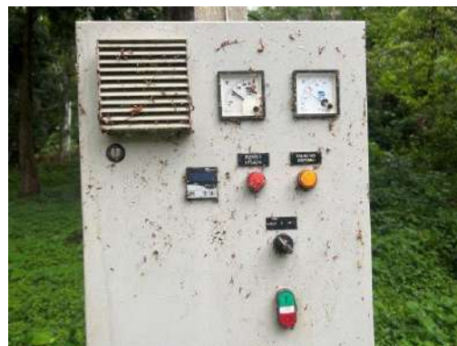
Quadro de comando
