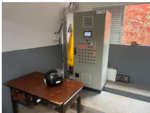
Quadro de comando e automação
