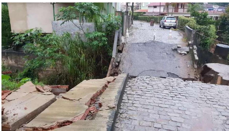
Figura 106 - Queda de ponte em 03/2018. Fonte: Mayron Sthefano | Arquivo Pessoal.
