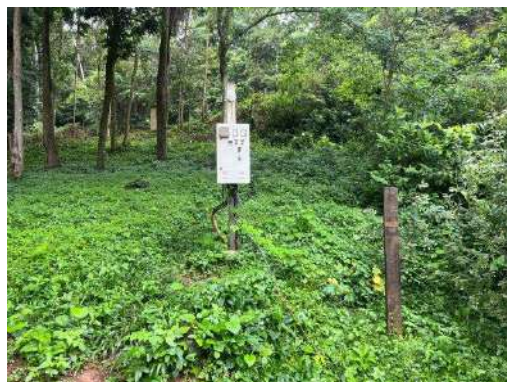
Quadro de comando
