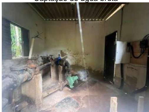
Captação de água bruta
