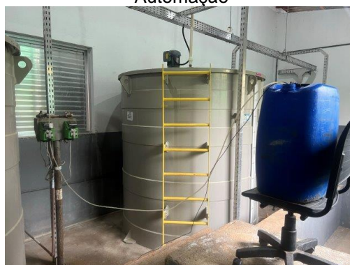
Preparo e dosagem de produtos químicos
