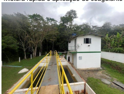
Floculação e decantação
