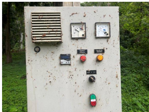
Quadro de comando
