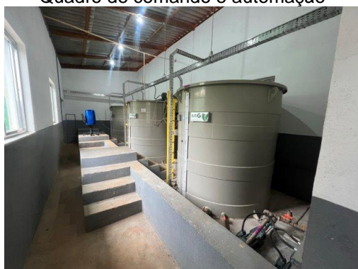
Preparo e dosagem de produtos químicos
