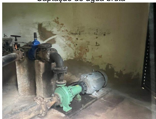
Captação de água bruta
