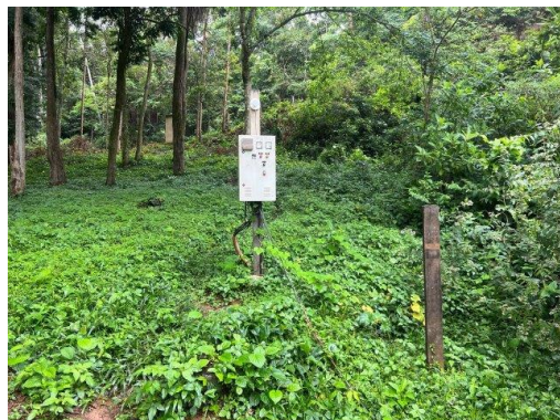
Quadro de comando
