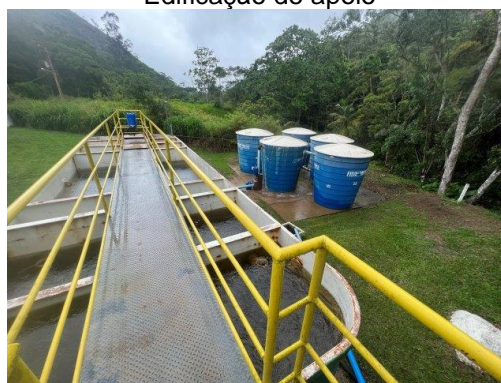
Floculação e decantação
