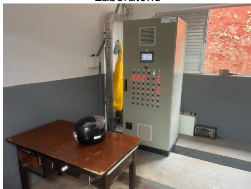
Quadro de comando e automação
